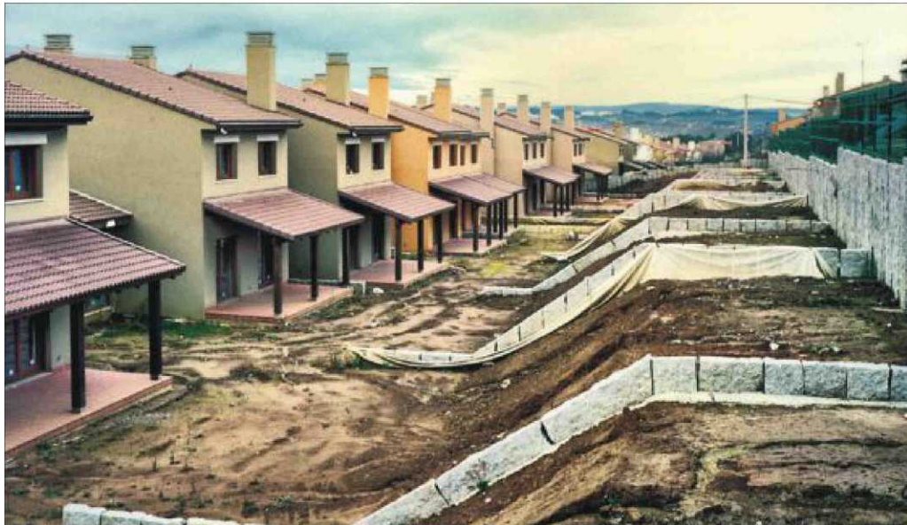
Promoción inmobiliaria paralizada a medio construir en la localidad de Miño (A Coruña). / ALFREDO CÁLIZ
